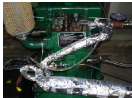
Circuit d'huile de palme chauffé et isolé
